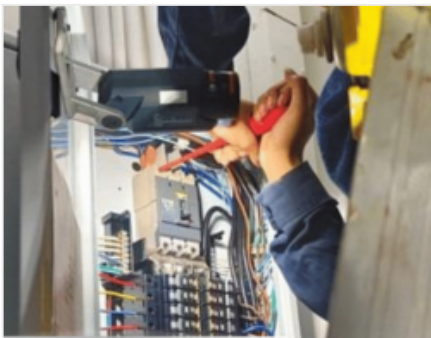
ตรวจสอบ รับรอง ติดตั้ง ระบบไฟฟ้าโรงงาน / อาคาร 099-203-8137 รับดำเนินการช่าง เป็นมืออาชีพ ช่างดี
